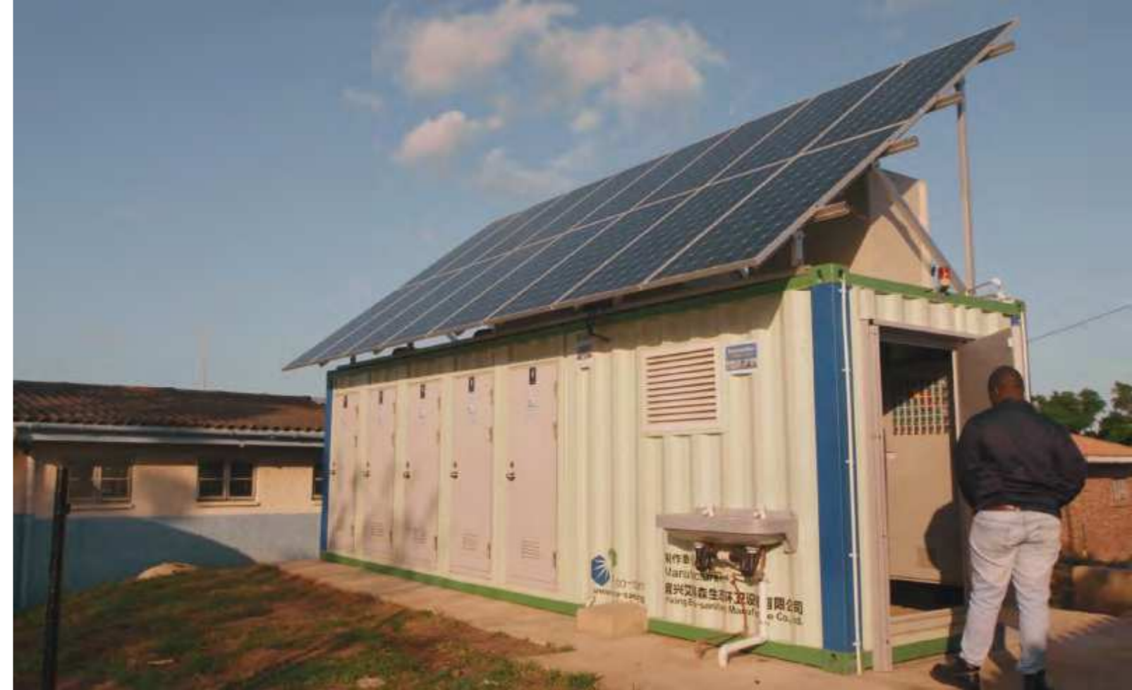
SERVICIOS HIGIENICOS ALIMENTADOS CON ENERGIA SOLAR
